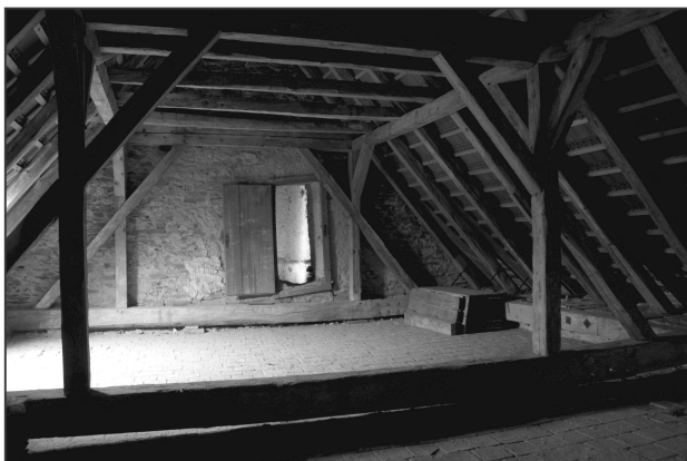
Obr. 10: Olešky (okr. Praha-východ), kostel Narození Panny Marie. Pohled na západní štít lodi s průhledem do druhého patra věže (foto M. Falta 2018).
